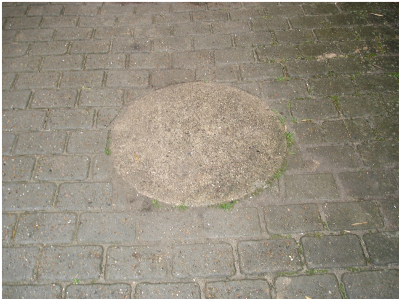
Alm. gammelt Ø600 betondæksel.
