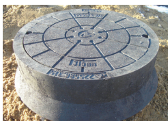
Nedsænket dæksel i kegle, ingen nedfald.
