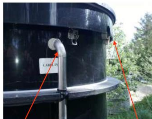
Kabelgennemføring til teknikkasse
