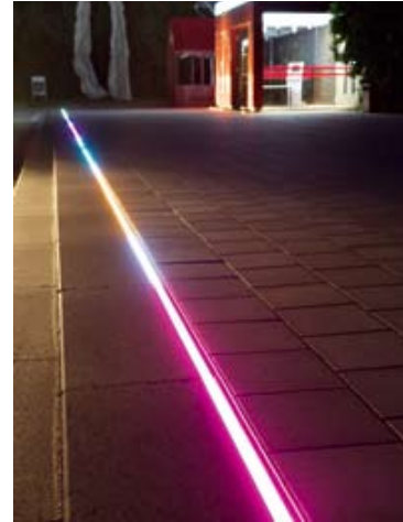
Liniedræn diskret sammenbygget med designlys
